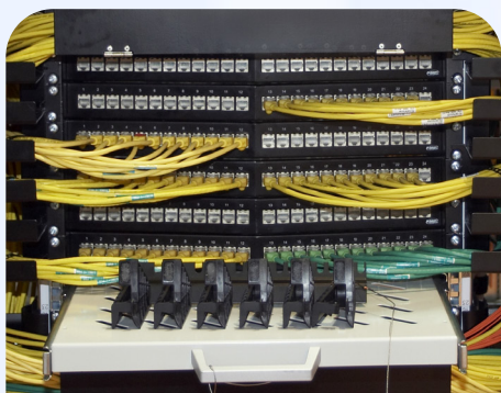
综合布线系统
