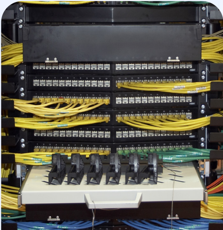
综合布线系统
